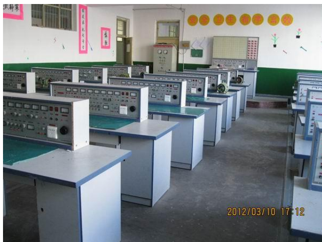
电子电工实训室
