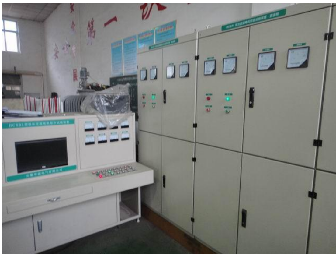
电机综合试验检测装置
